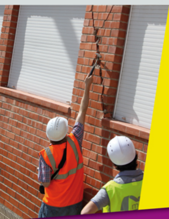
Inspection d'un bâtiment endommagé suite au séisme de Lorca du 11 mai 2011 (source : AFPS)
