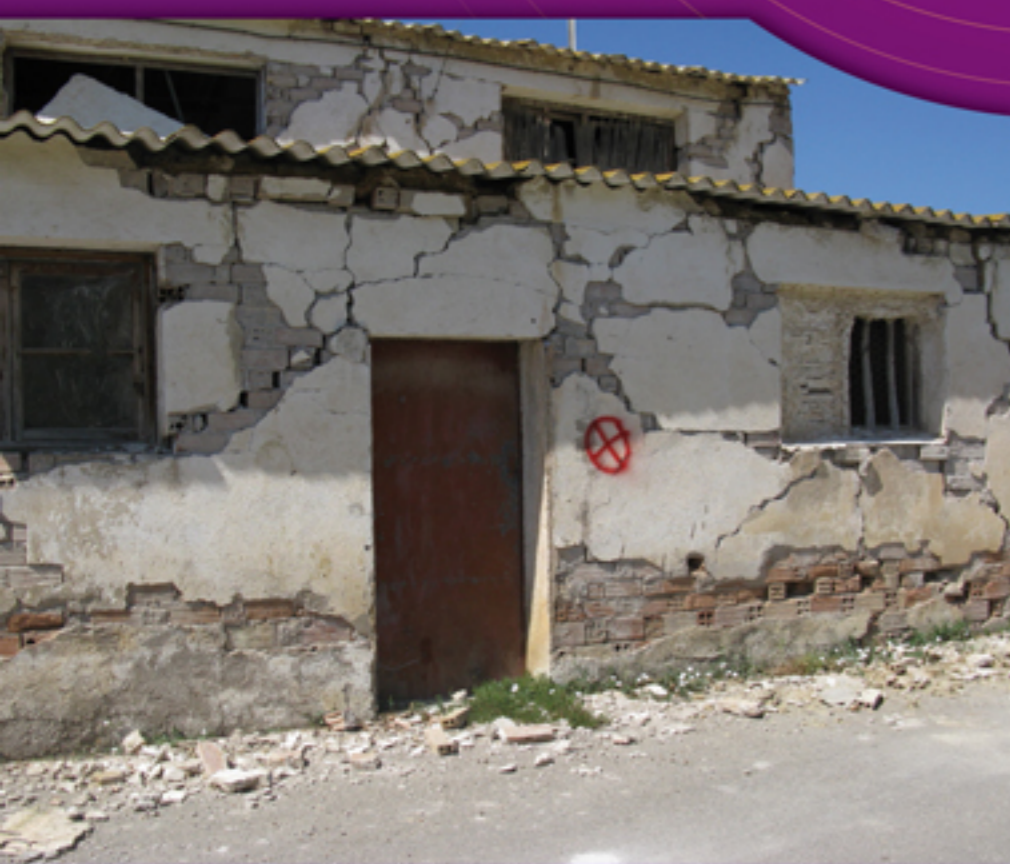
Marquage de bâtiments endommagés en Espagne en 2011 (source : AFPS)
